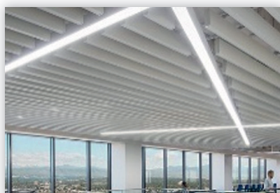
Gestion et optimisation de l'éclairage
